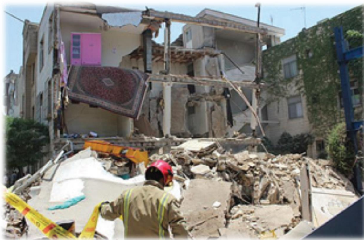
تخریب حادثه ساز
