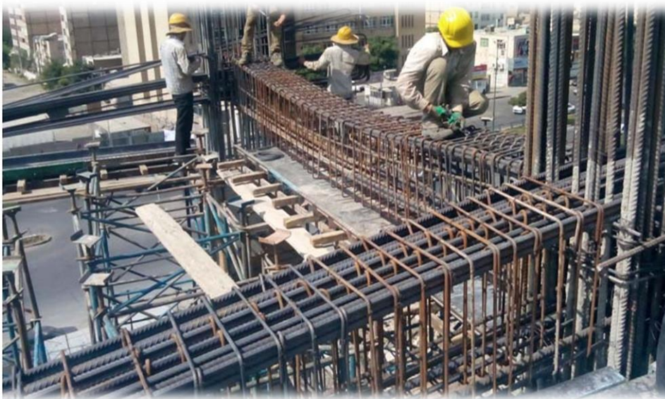
نمونه‌ای از کار نایمن در عملیات آرماتوربندی
