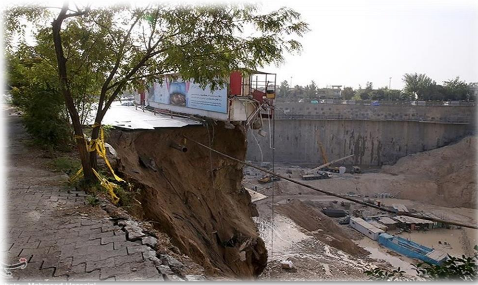
حادثه شهرک غرب تهران - نشت آب به داخل گود
