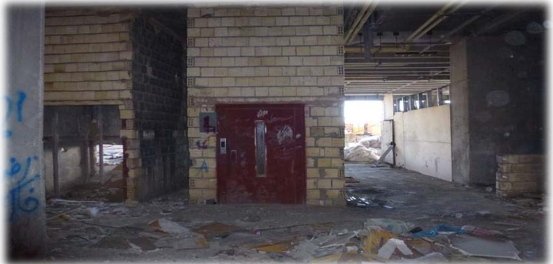
شکل ۲- آسانسورهای نفربر بلااستفاده در کارگاه
